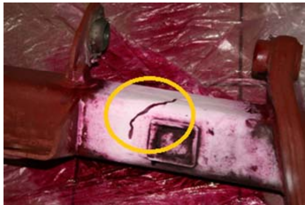
Рис. 16. Вид оси полуприцепа с обнаруженной трещиной методом проникания
