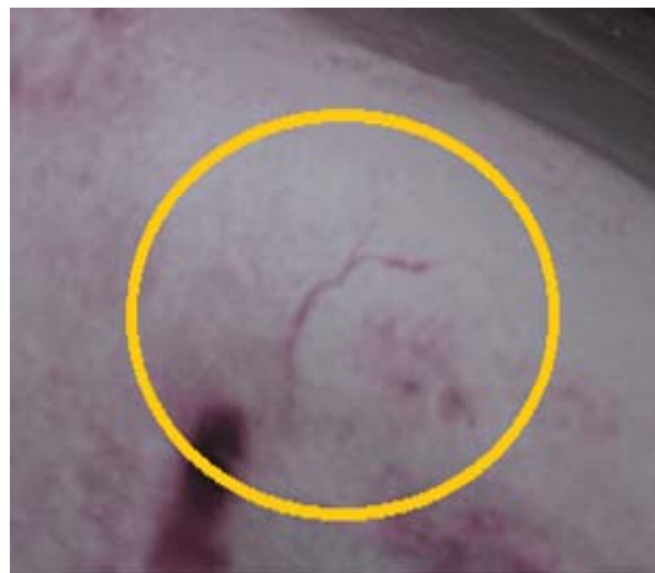
Рис. 20. Обнаружена трещины в оси полуприцепа
